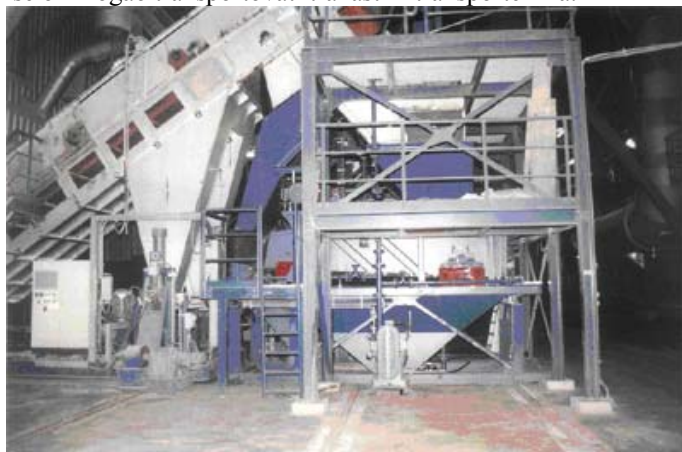
Slika 1. Odvodnjavanje kotlovskog pepela iz vlažnog odpepeljivača sa MAB-uređaja za odvodnjavanje vlažnog pepela
