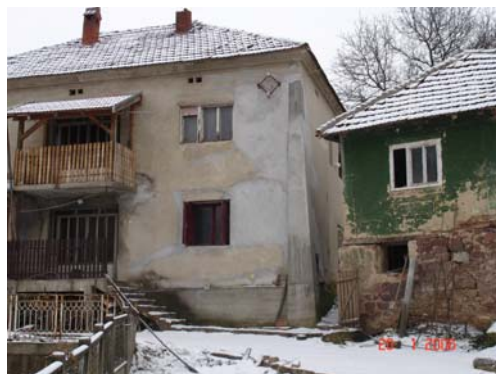
Slika 3. Sanacija objekta oštećenog pomeranjem potkopanog terena
