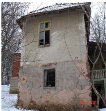
Slika 2. Pojave oštećenja na objektima
